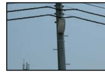
写真3: 工場外灯のLED化
